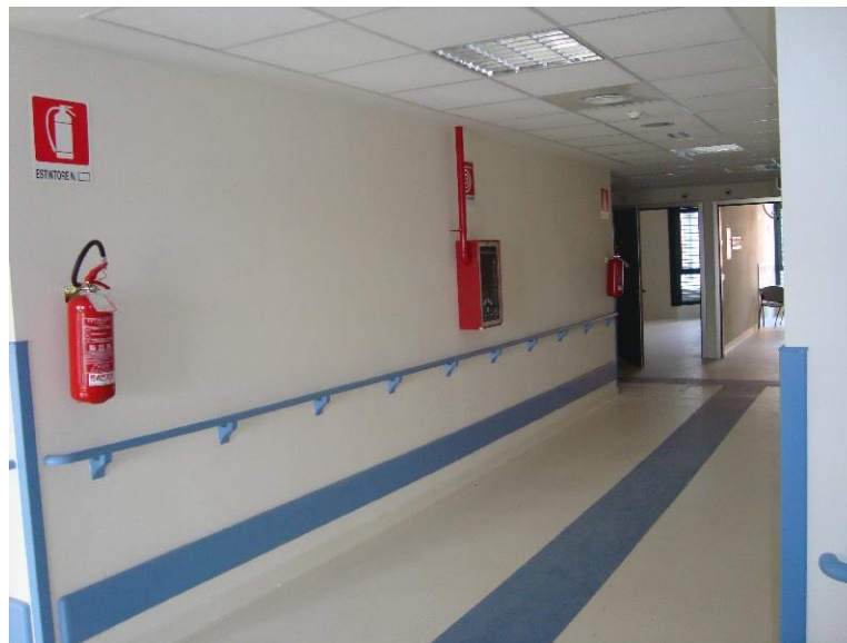
Рисунок 99 – Пример оборудования палатного отделения первичными средствами пожаротушения
